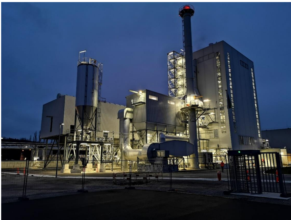
Cogénération Biomasse de Novillars.
